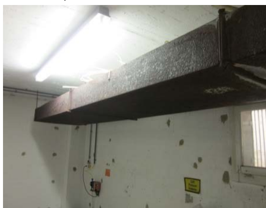
Système de ventilation existant en mauvais
