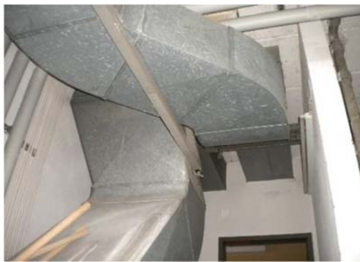
Système de ventilation existant
