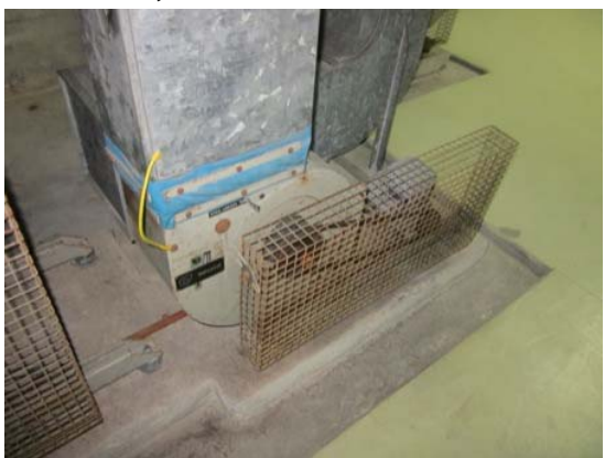
Bloc- moteur obsolète
