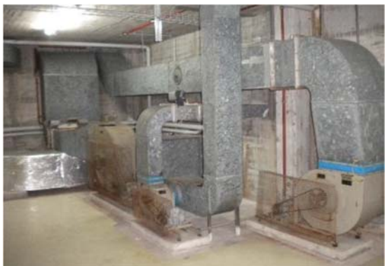
Système de ventilation existant
