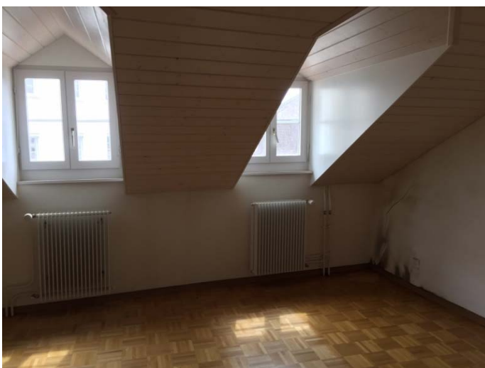
Dégâts de fumée et d'eau
