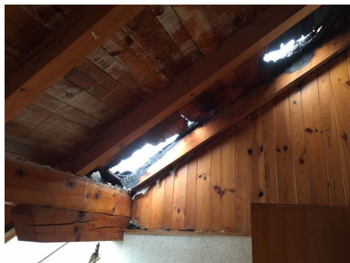
Toiture percée et isolation détruite
