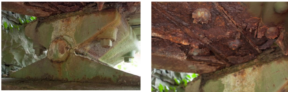
Figure 5 : Etat de l'appui nord côté Lyss
