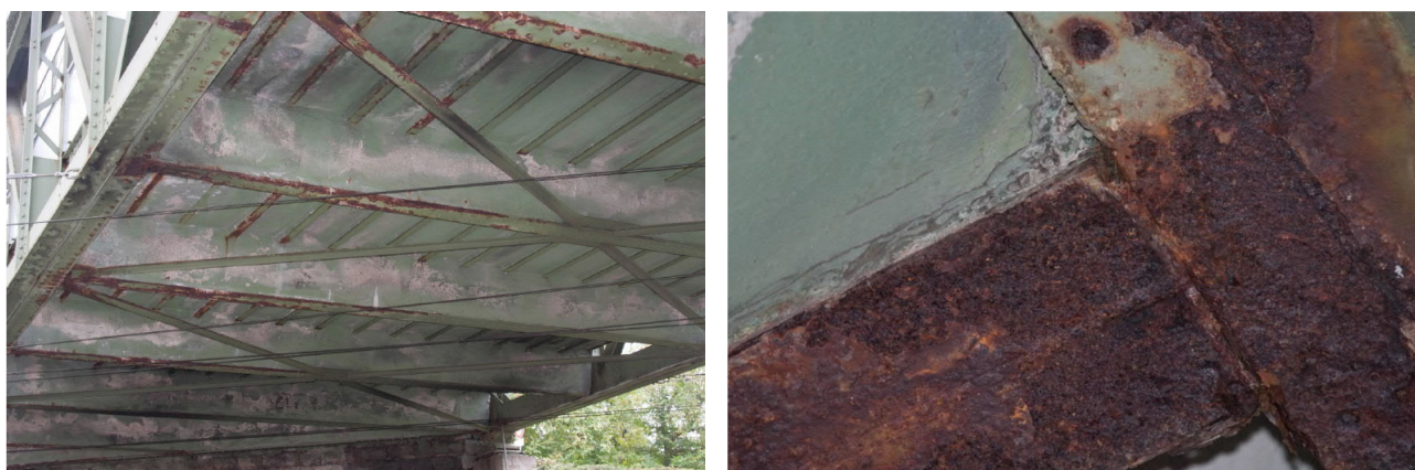
Figure 6 : Etat du tablier
