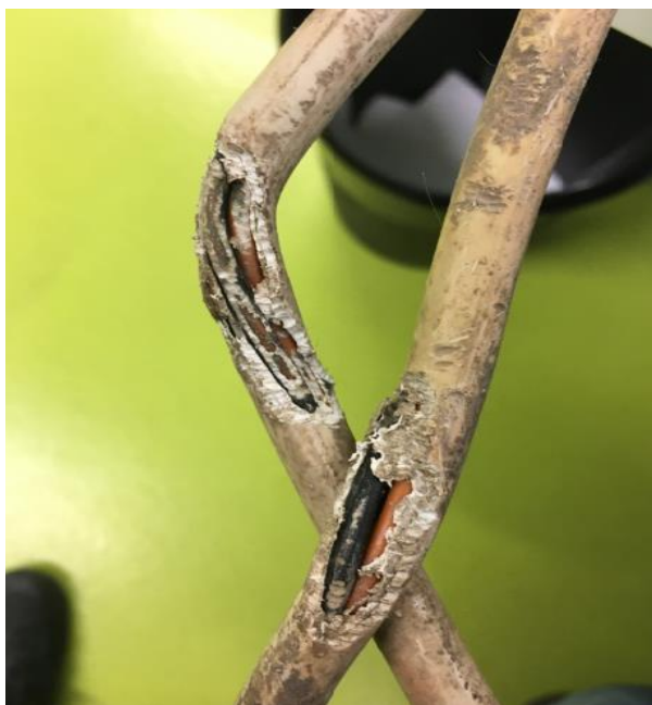
Câbles endommagés par les rongeurs
