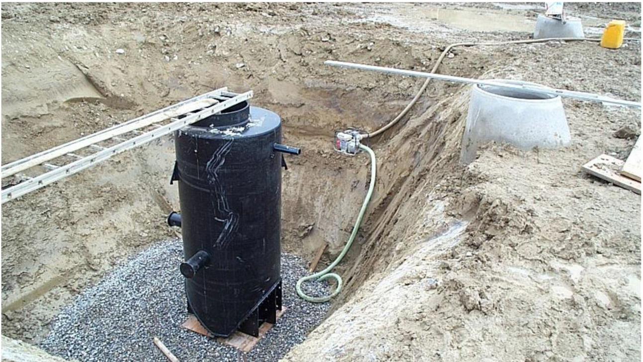
Point de collecte des eaux usées et réseaux d'acheminement vers station intermédiaire par système d'aspiration
