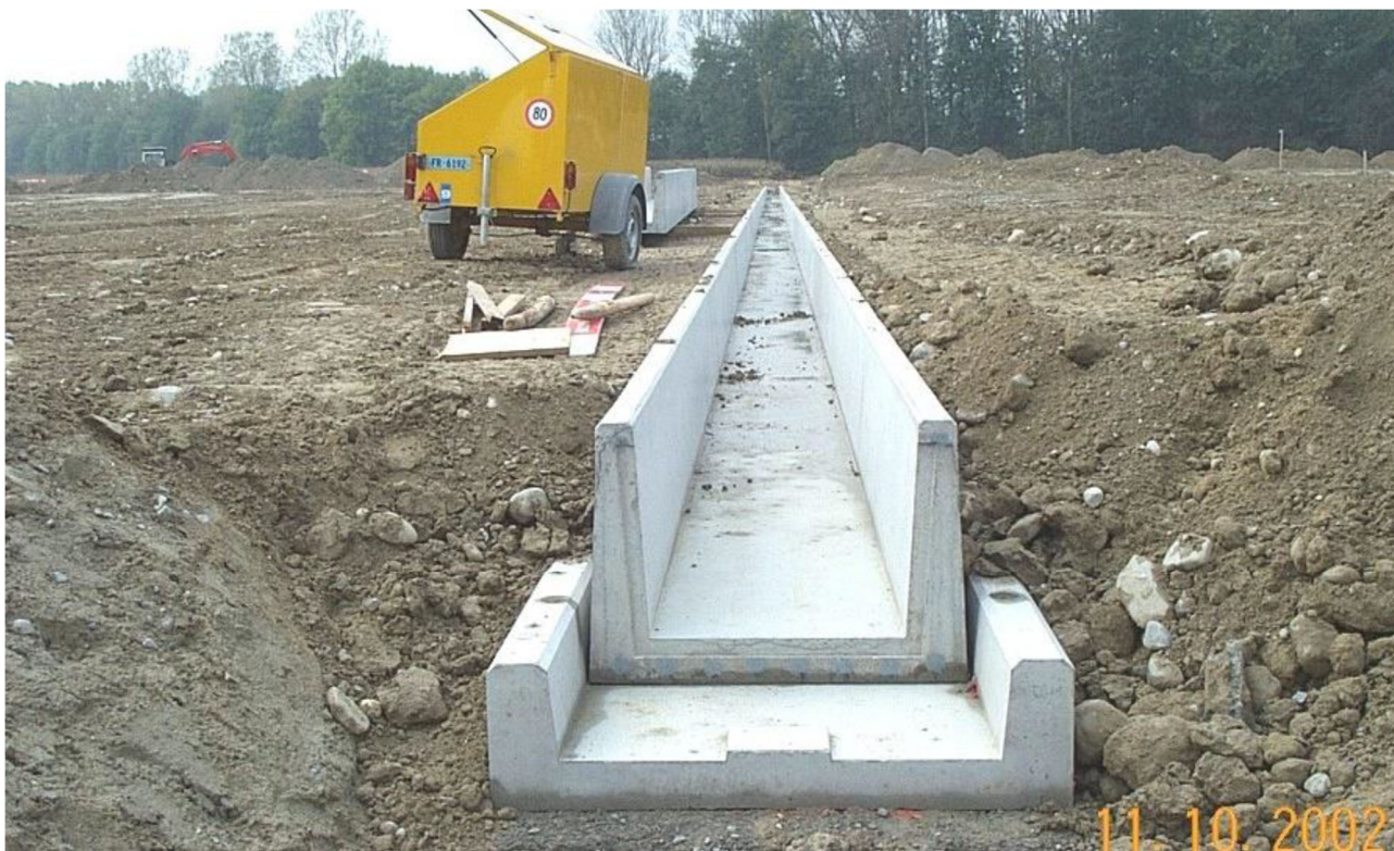
Réseau de caniveaux à ciel ouvert pour la récolte des eaux de surface
