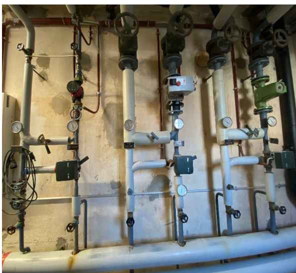
Distribution de chauffage de L'Ancienne Promenade
