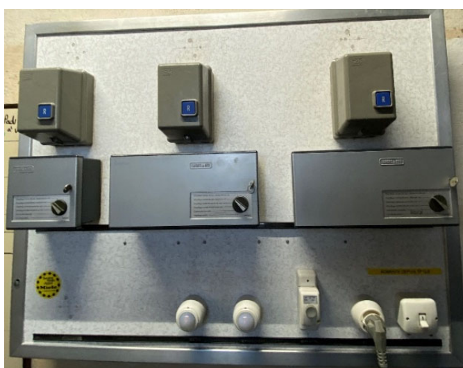
Régulation de chauffage de l'Ancienne Promenade
