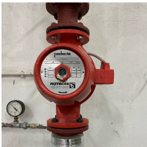
Pompe principale de chauffage
