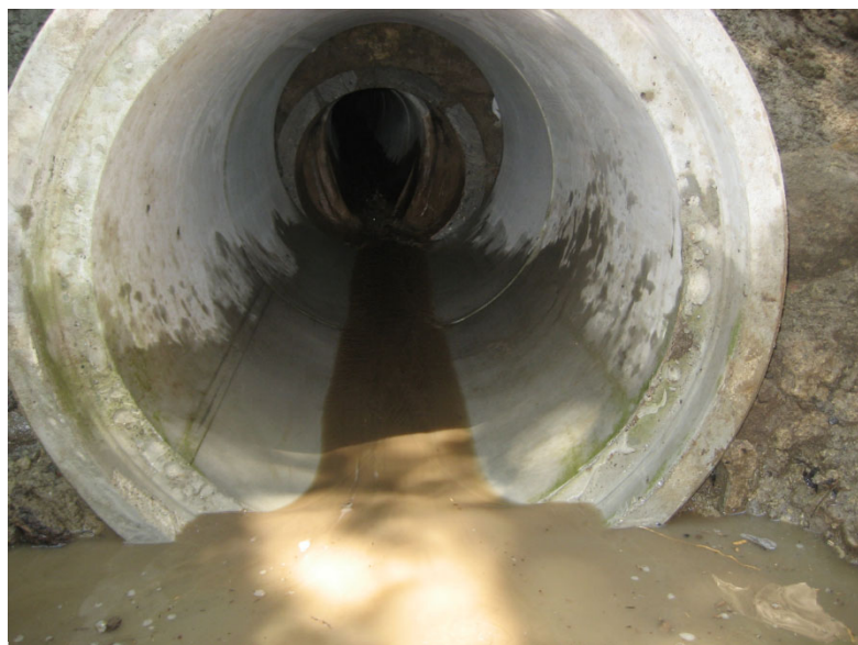
Figure 3 : Détail de l'assemblage approximatif de différents tuyaux traversant la route, côté aval
