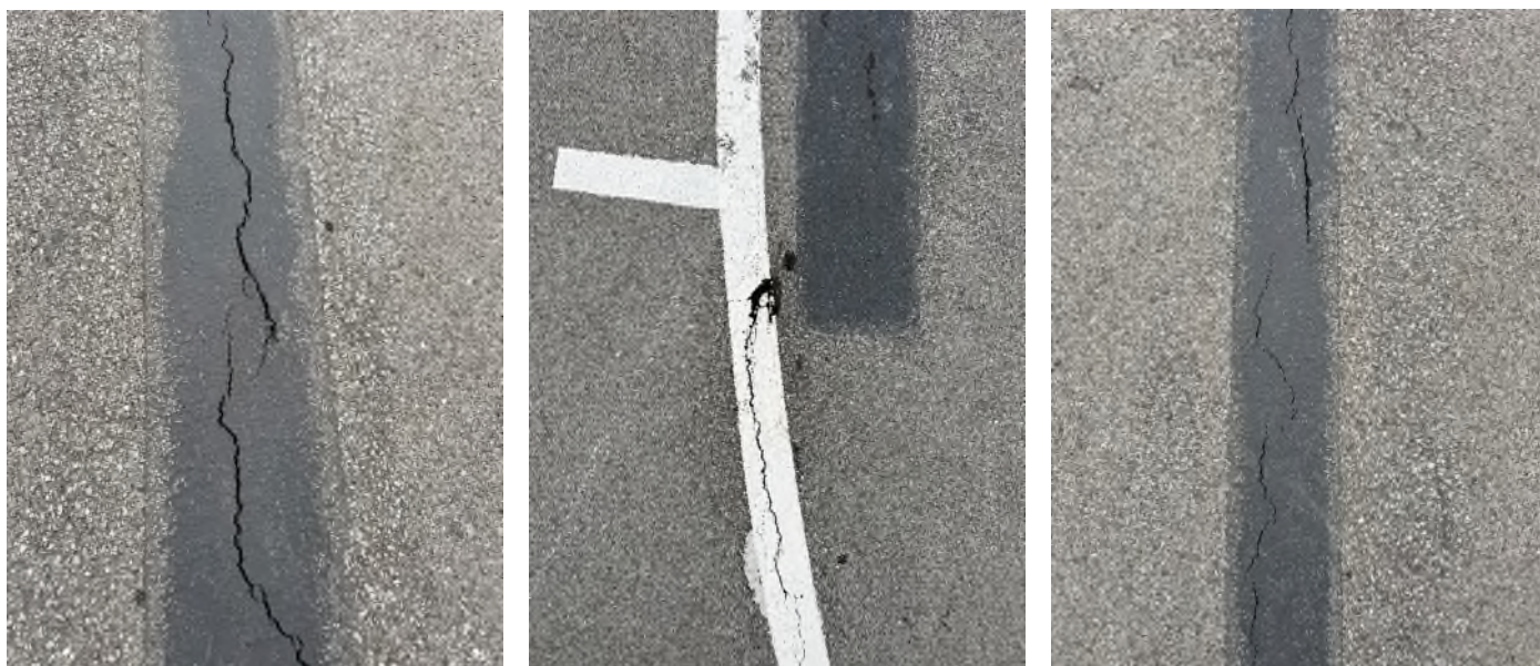
Réapparition de fissures après les réfections de 2024
